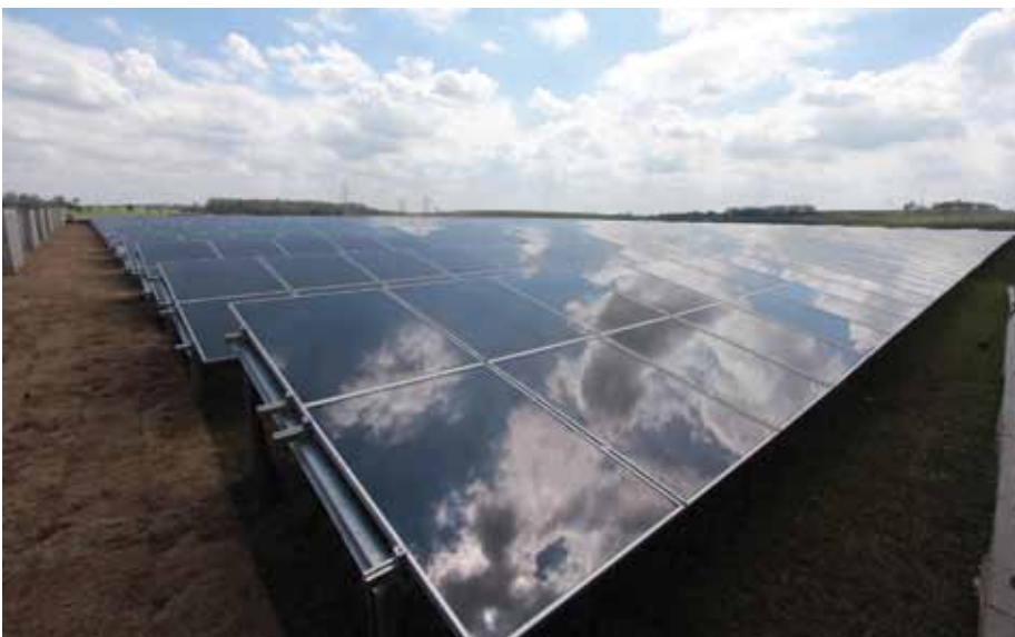
Usina solar de Tanquinhos, em Campinas (SP)
